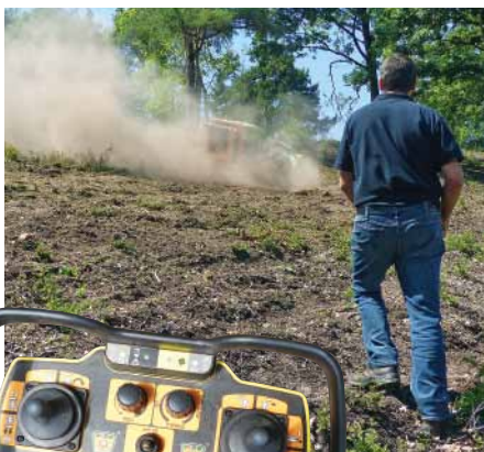
Hier wird deutlich, welch großen Vorteil die Fernsteuerung hat: Der Bediener steht außerhalb des Gefahrenbereichs völlig ohne Staubbeeinträchtigung.
